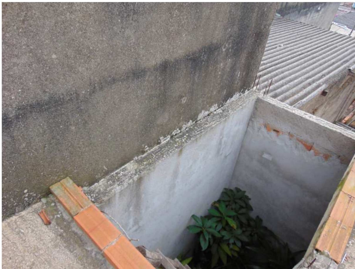
INEXISTÊNCIA DE RUFOS ENTRE OS MUROS.
