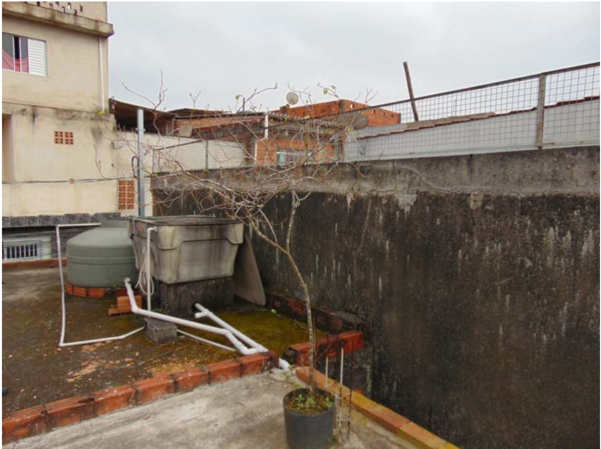
VISTA PARCIAL DA LAJE DA GARAGEM DOS AUTORES, COM AUSÊNCIA DE IMPERMEABILIZAÇÃO E PRESENÇA DE PROLIFERAÇÃO DE LIMO (BIOFILME).
