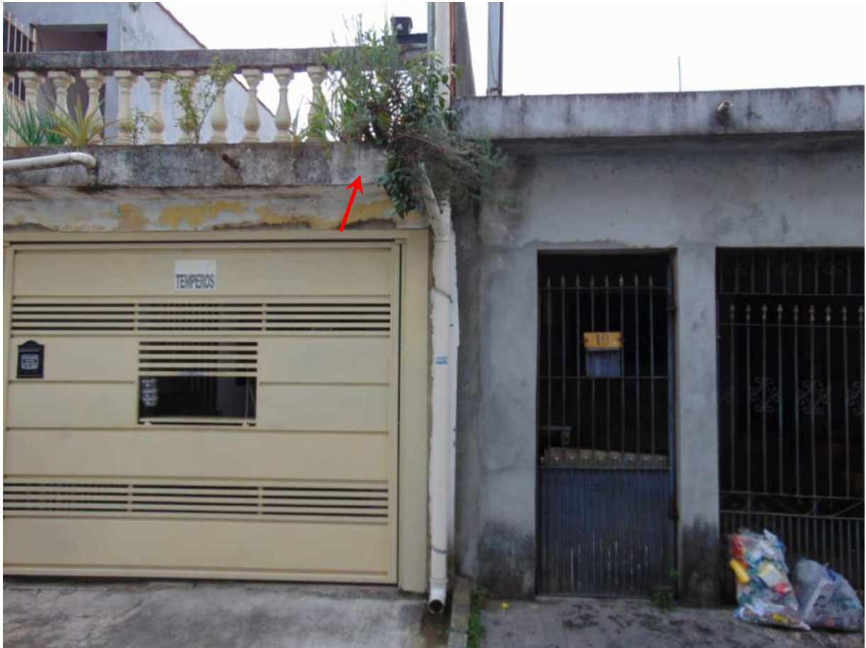
DESTAQUE PARA TUBULAÇÃO QUE FORA REMOVIDA.
