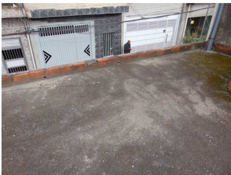
DETALHES DA LAJE DA GARAGEM SEM IMPERMEABILIZAÇÃO.
