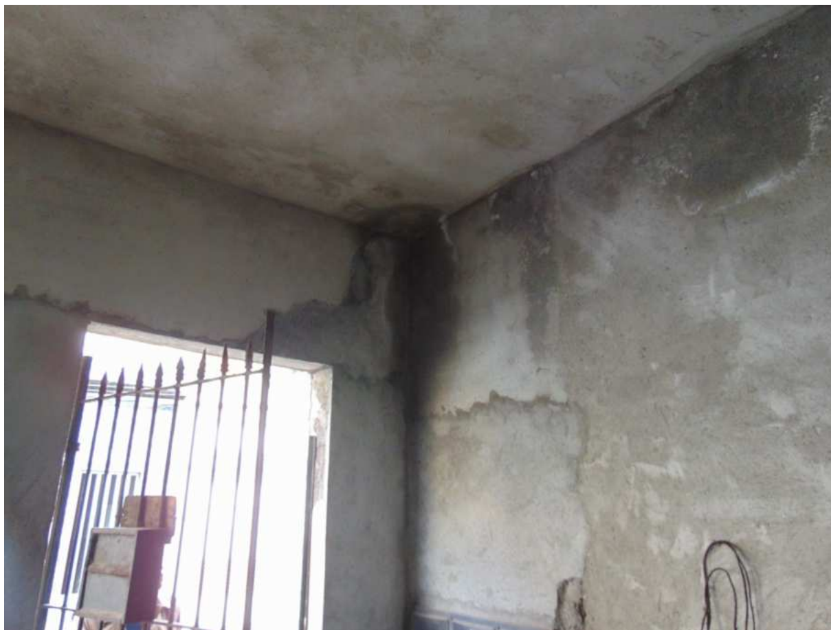
MANCHAS DE UMIDADE EM PAREDE E LAJE DA GARAGEM DOS AUTORES.
